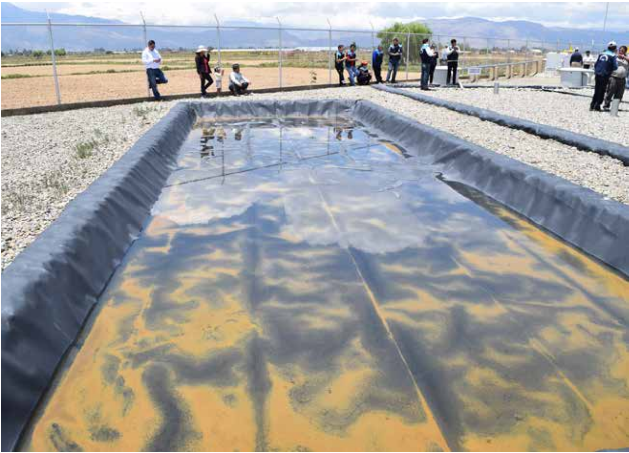
PTAR en Huasacalle.
